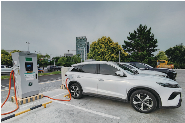
●车辆使用充电桩充电
